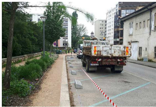
Quai GROBOZ : installation de bute-roues pour éviter le débord de véhicules en stationnement sur le trottoir
