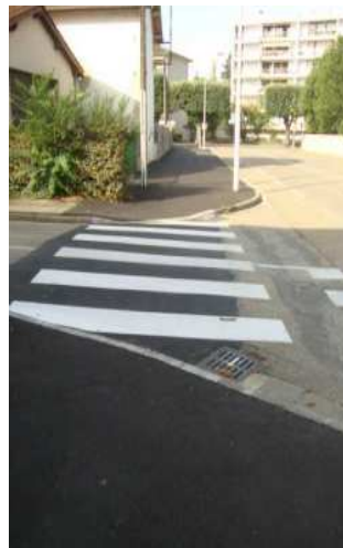
Avenue de L'EGALITE : mise aux normes de 2 passages-piétons et réfection du revêtement du trottoir
