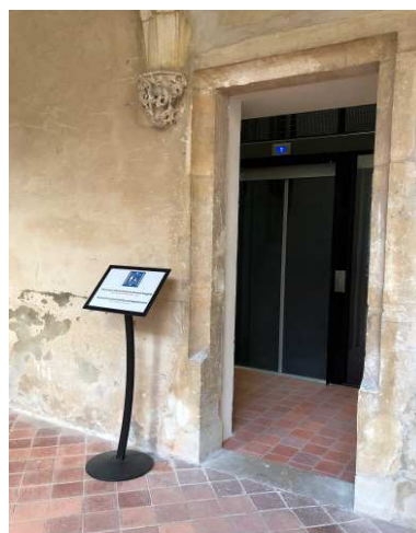
Monastère de BROU : création d'un ascenseur pour l'accessibilité de l'Église (jubé) et du Musée par la salle des États. Réfection du sol en pente douce de la salle des États pour reprise des niveaux. Travaux menés par le CMN avec participation ville de 50 %.
